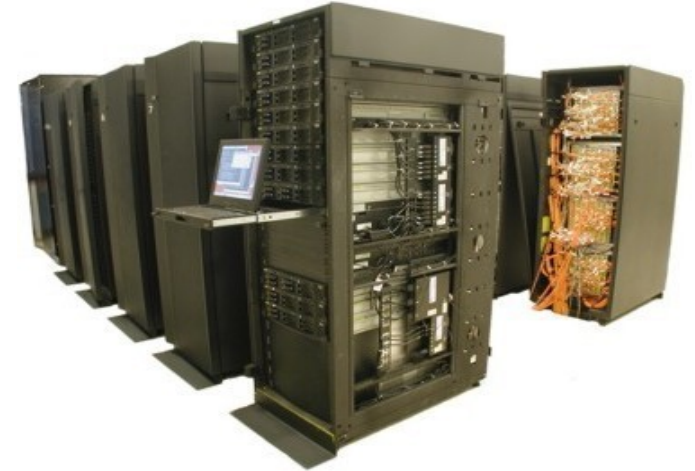
Rack di server blade
